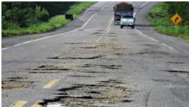
Má conservação, com buracos, falhas e pistas irregulares.
